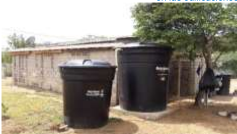
Instalación de colecta y almacenamiento de agua lluvia en las edificaciones
