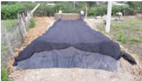
Adecuación de pozo de inspección para el almacenamiento de agua lluvia con zona de captación
